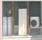
電気とガスのハイブリットタイプの給湯器「エコワン」を設置。
